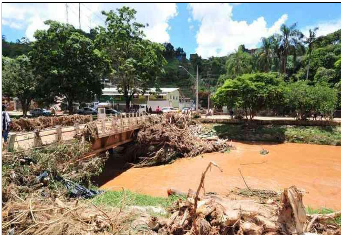
Figura 2: Pontes e Estruturas abaladas em Santa Maria de Itabira-MG no ano de 2021.
