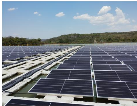
Figura 22. Gerador fotovoltaico Santa Marta
