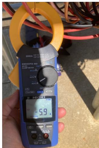
Figura 39. Medição da corrente reversa nos módulos do gerador fotovoltaico da usina São João Nepomuceno
