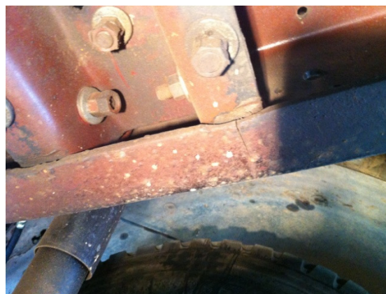
Foto: Trinca em longarina. Fotos do autor.
