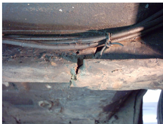
Foto: Rompimento de longarina. Fotos do autor.
