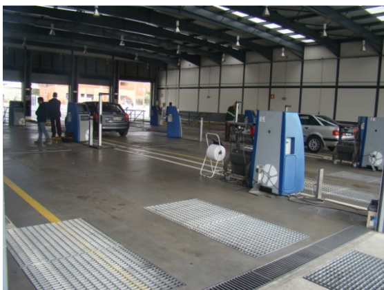
Foto: Grade para limpeza dos pneus. Fotos do autor.
