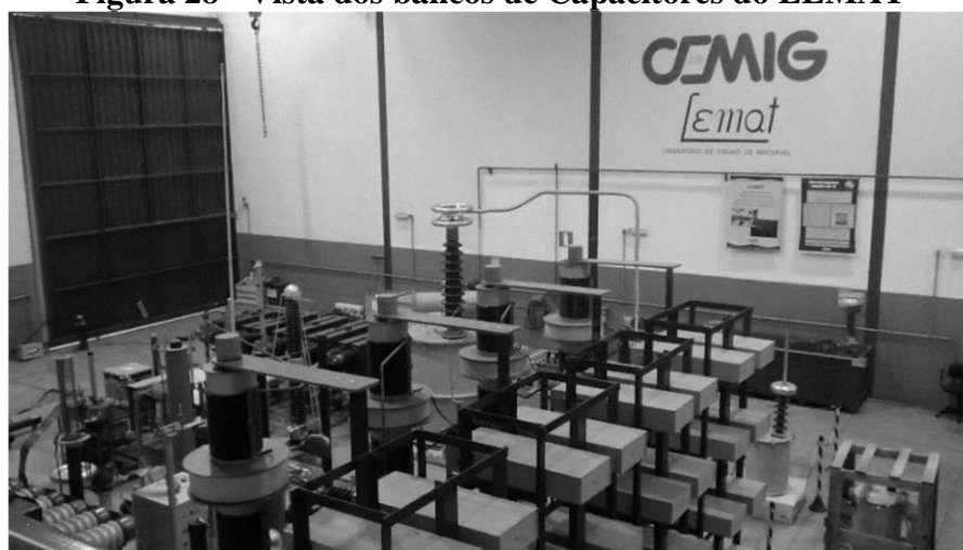
Figura 28 - Vista dos bancos de Capacitores do LEMAT
