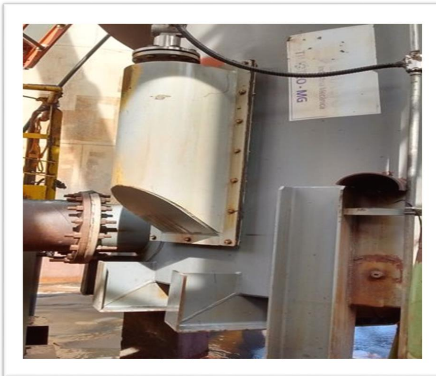
Figura 09 - Tanque com medidor de densidade e tubulação de saída
