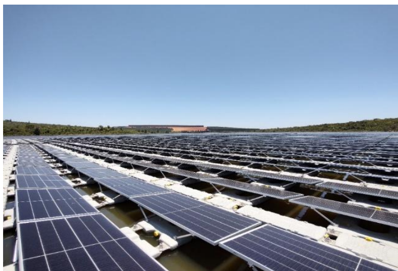
Figura 37 - Vista do gerador fotovoltaico da UFVf em Grão Mogol
