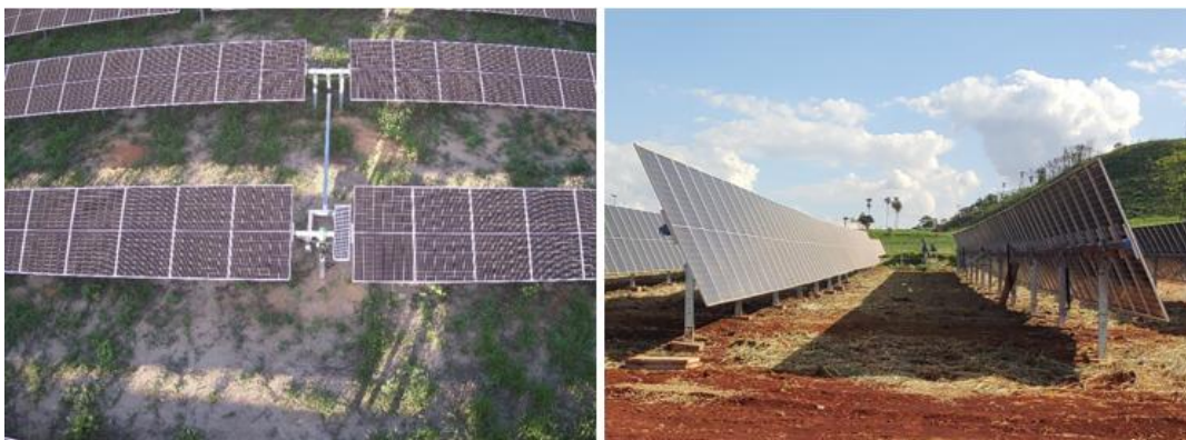
Figura 9 - Arranjos solares fotovoltaicos instalados em estrutura do tipo seguidor
