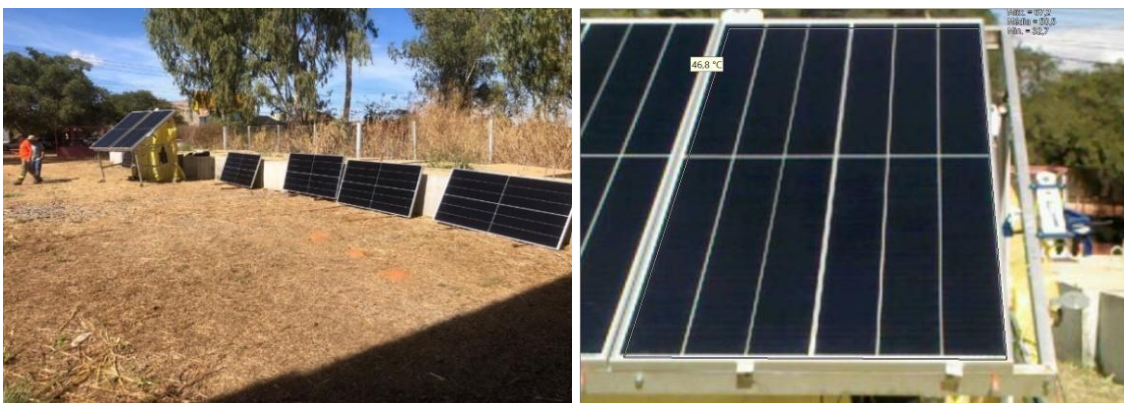
Figura 29 - Módulos fotovoltaicos em ensaios termográficos – IR
