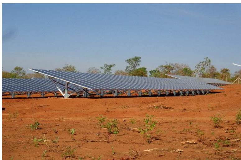
Figura 32 - Arranjos fotovoltaicos da implantados na UFV em Corinto
