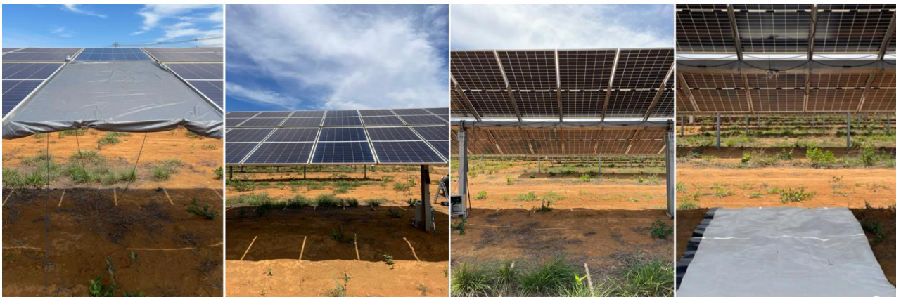
Figura 91. Imagens das medições curva IxV – UFV Corinto
