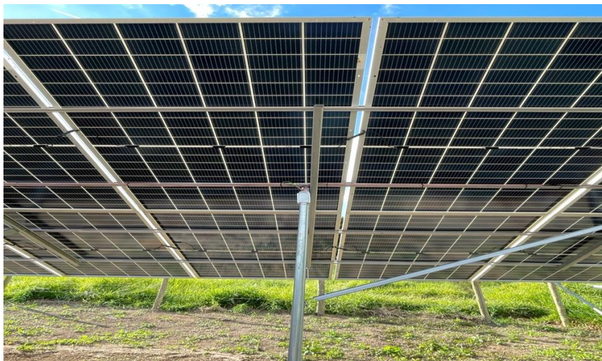
Figura 52. Detalhe estrutura de fixação módulos FV bifaciais – UFV Itaguara
