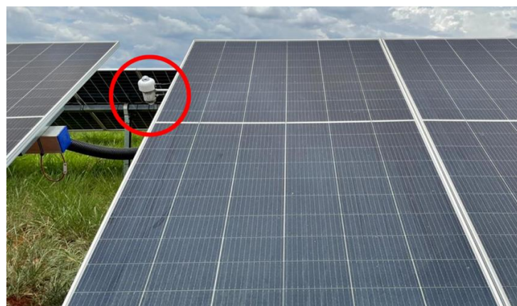
Figura 44. Albedômetro instalado na UFV Iguatama
