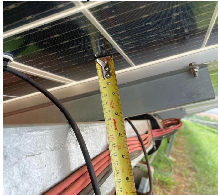
Figura 75. Distância do tubo de torção da estrutura de rastreamento solar em relação ao módulo
