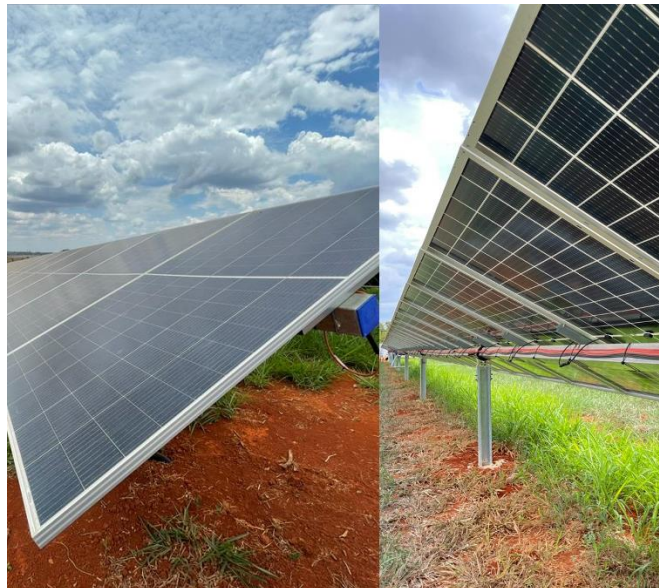
Figura 70. Gerador fotovoltaico e solo da UFV Iguatama
