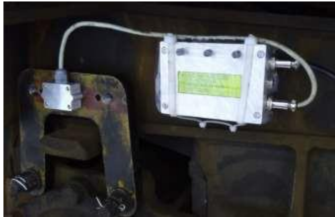
Foto 30 – Equipamento instalado no truque
