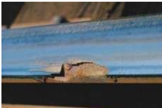
Foto 16: Despedaçamento do canto da Bitola
