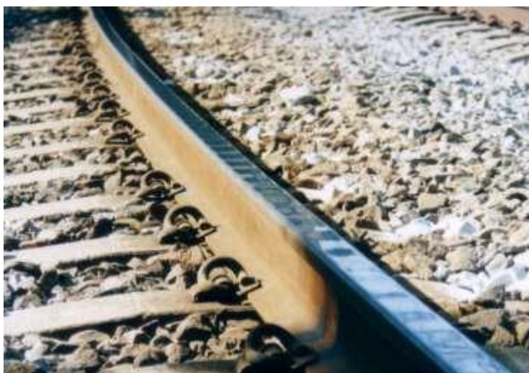
Foto 11- Corrugação na via de Belo Horizonte
