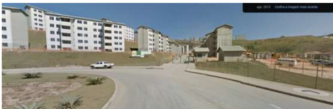
Figura 29: Imagem de 2013 do Residencial Hematita no começo da realização das obras. Endereço: Rodovia, Anel Rodoviário Celso Mello Azevedo, 27001 - PauloVI, Belo Horizonte – MG
