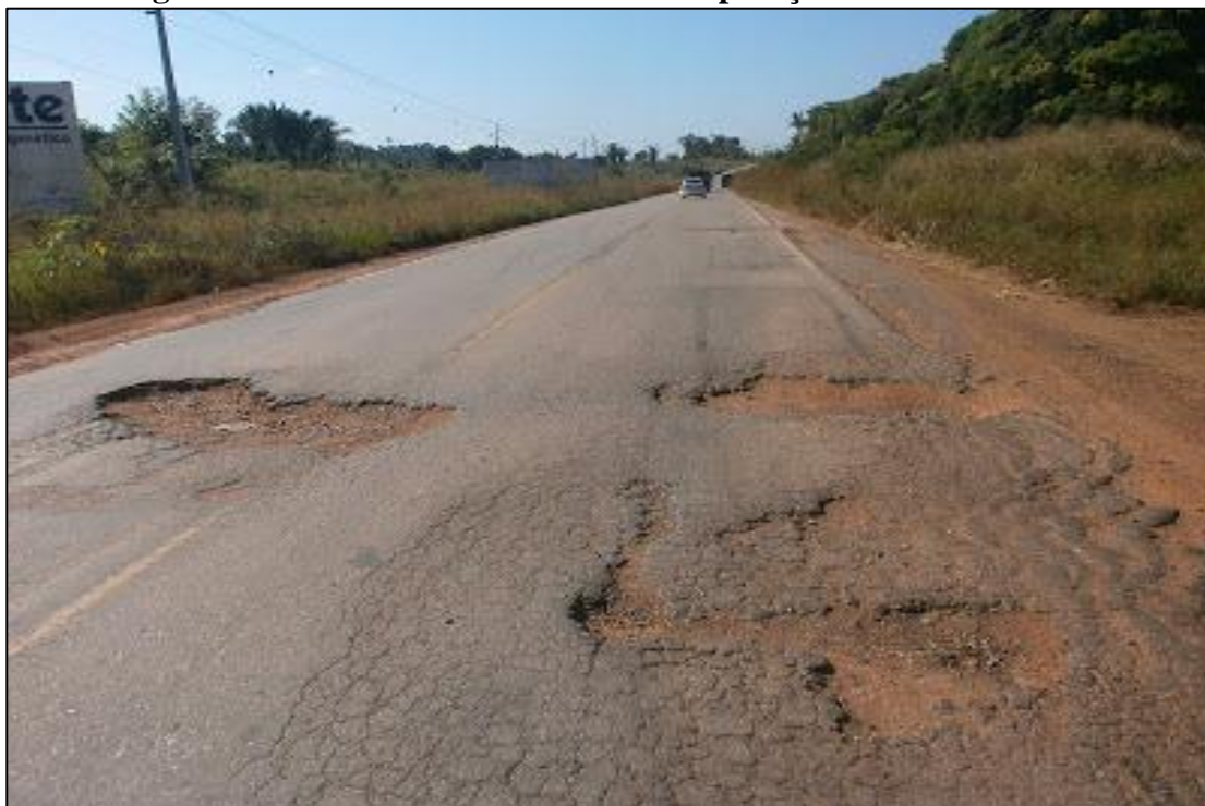
Figura 9- Rodovia PA-279 antes da recuperação do asfalto.
