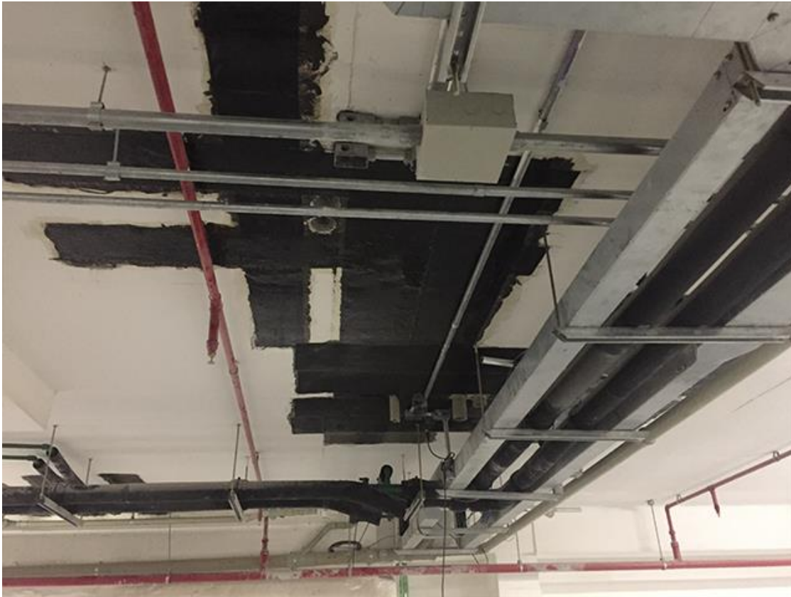
Figura 19 - Tubulações instaladas próximo ao local do reforço
