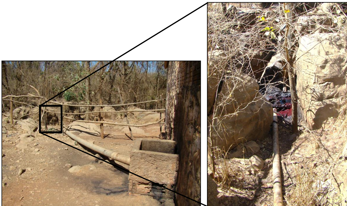
Figura 25 - Resíduos e efluentes de um matadouro no norte de Minas Gerais sendo descartados em um sumidouro
