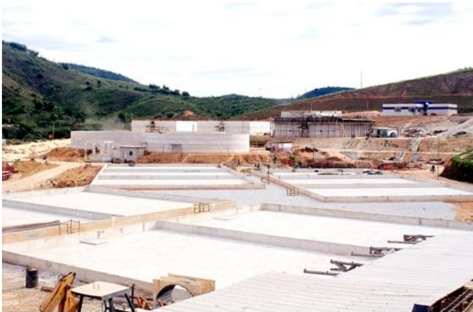
Estação de Tratamento de Esgoto - ETE
