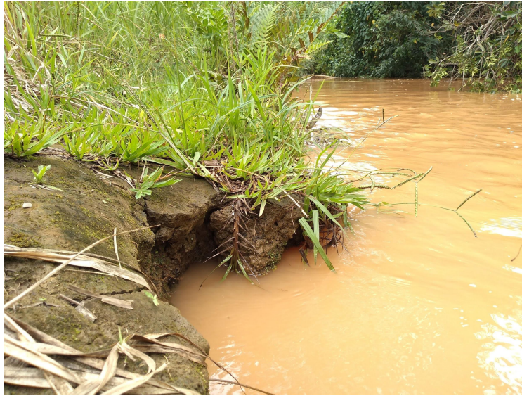
Figura 36 - Escavação fluvial a jusante do barramento.
