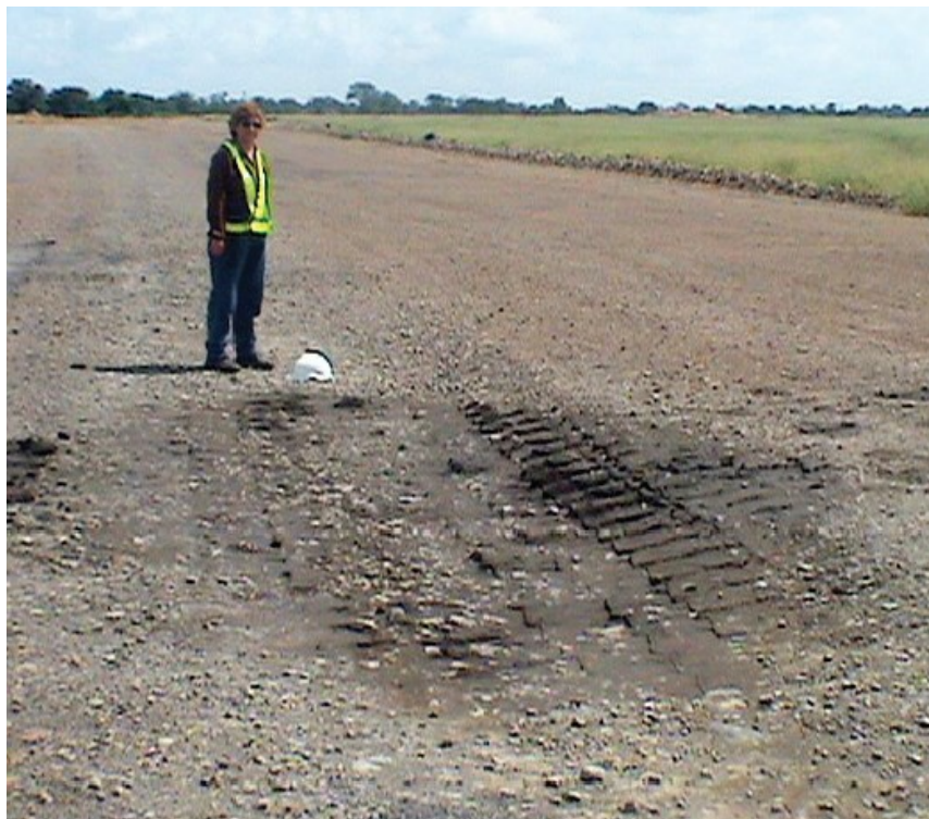
Imagem 31 - Buraco formado por acúmulo de água
