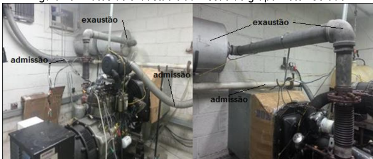
Figura 28 - Dutos de exaustão e admissão do grupo Motor-Gerador
