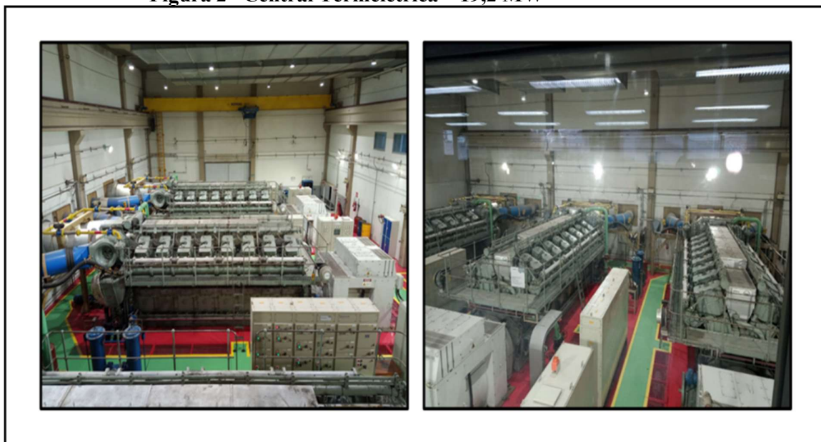
Figura 2– Central Termelétrica – 19,2 MW
