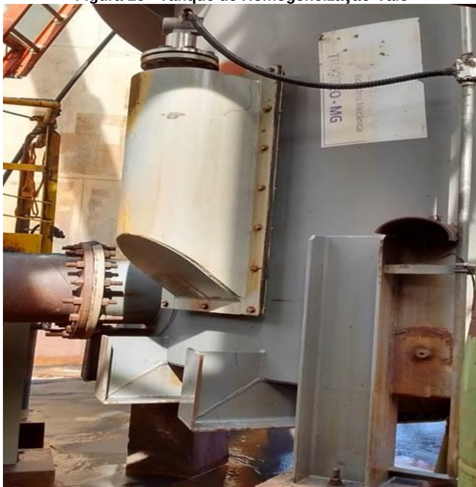
Figura 26 - Tanque de Homogeneização-Vale
