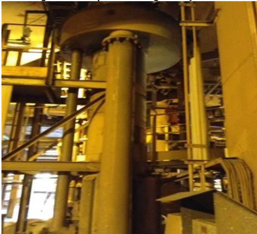
Figura 7 - Tanque de Homogeneização-Vale
