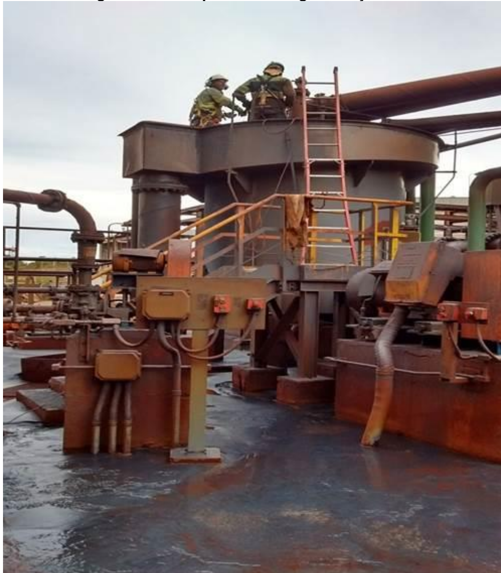
Figura 25 - Tanque de Homogeneização-Vale
