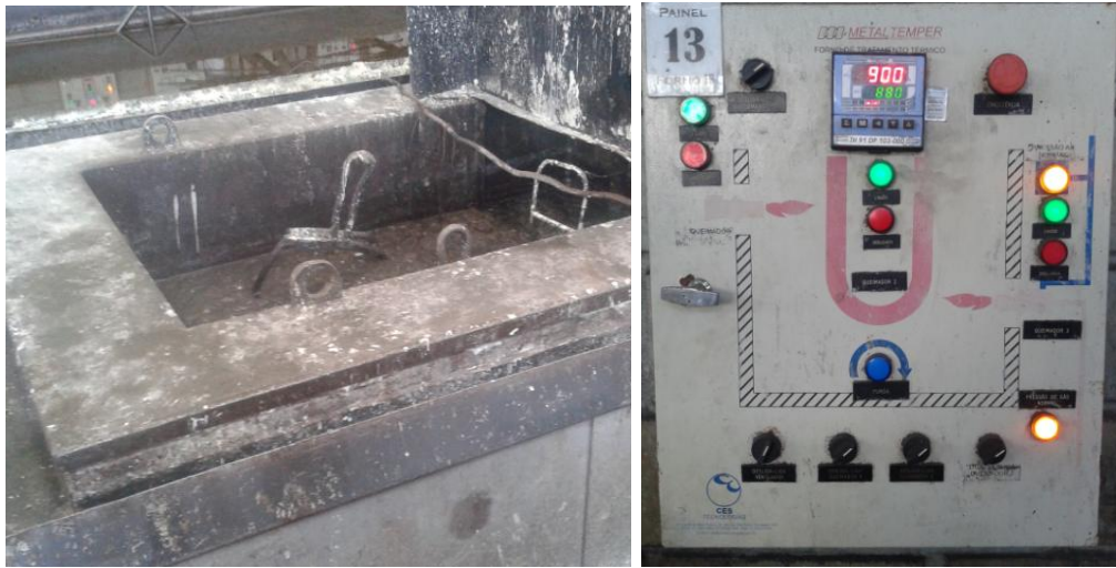
Figura 21 – Forno elétrico com banho de sal – austêmpera
