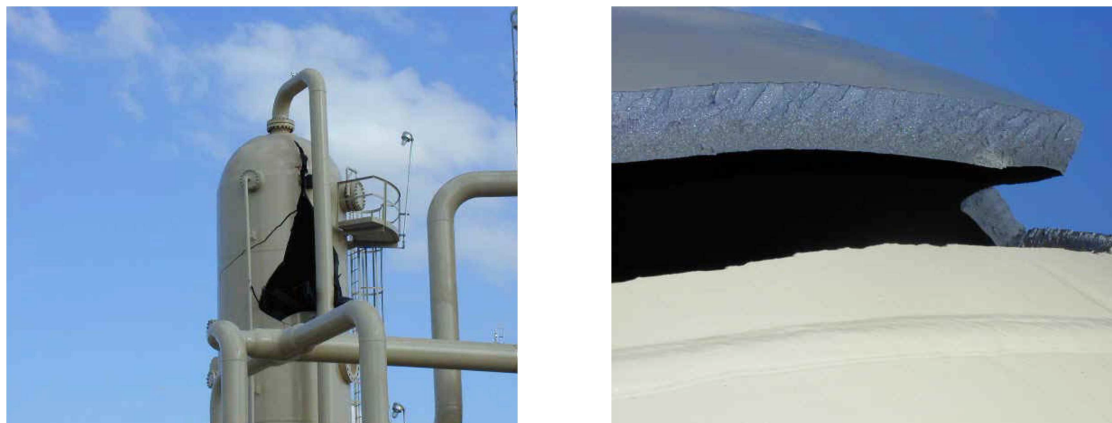
a) Vaso de pressão com falha catastrófica.
