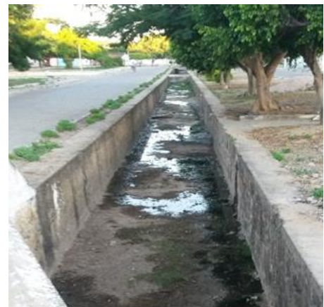
Figura 03 - Valeta com esgoto a céu aberto Fonte: Maria Freire
