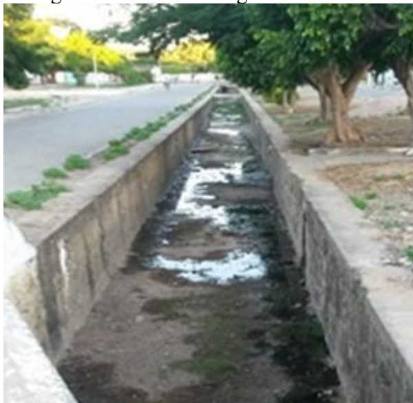
Figura 3 Valeta com esgoto a céu aberto
