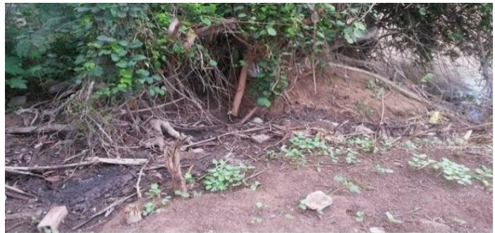
Figura 7 - Esgoto sendo lançado diretamente ao Rio Sincorá Fonte Maria Freire
