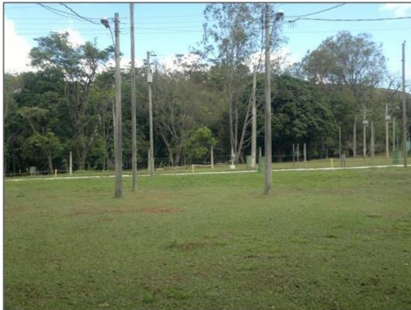
Fotografia 6 - Redes aéreas de energia energizadas
