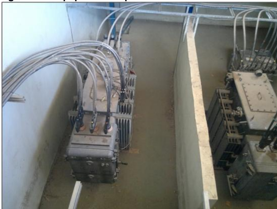
Fotografia 8 - Equipamentos para redes subterrâneas de energia
