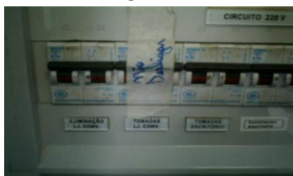
Identificação Inadequada – Em desacordo com a NR-10
