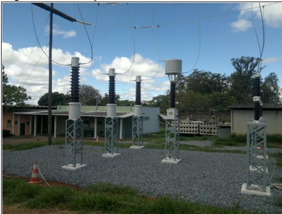
Fotografia 3 - Subestação no centro de treinamento UNIVERCEMIG
