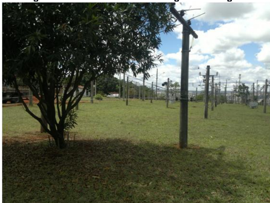
Fotografia 5 - Redes aéreas de energia desenergizadas
