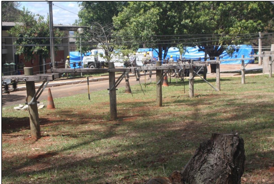
Fotografia 4 - Redes aéreas de energia no nível solo
