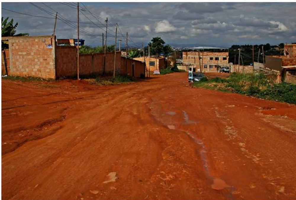
Figura 12 - Foto das ruas sem asfaltamento da Ocupação Dandara.
